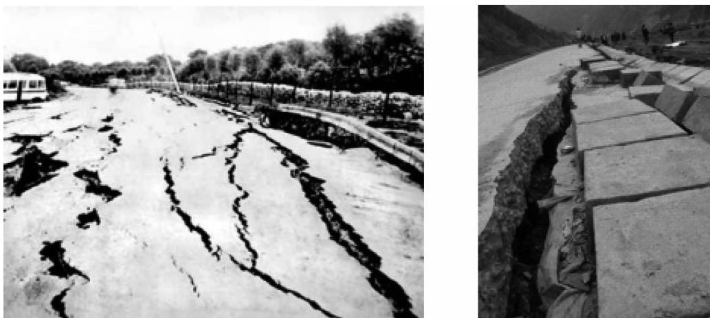
图 1.5 5.12 地震引起的地裂缝
